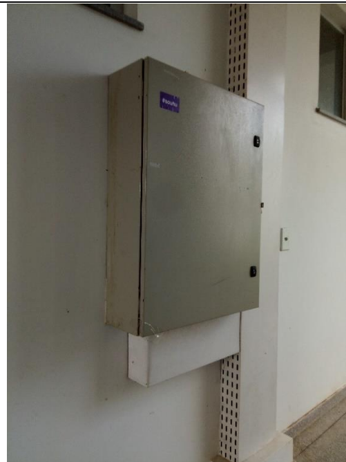
(Figura 3) caixa de energia onde ficam pendurados avisos formais
