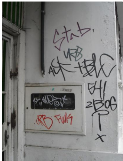
Figura 1: exemplo de pichação feita na cidade de Santa Maria.
